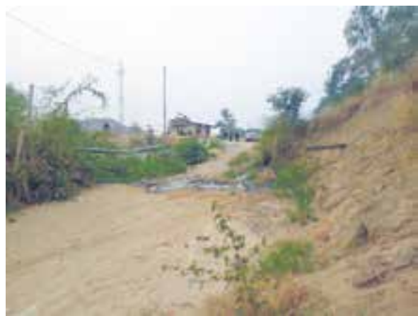
Image 18 : Érosion sur la route menant vers la mission Kimwenza
